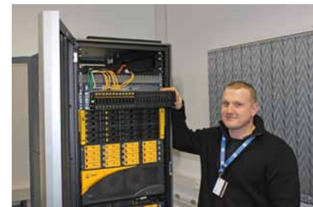
Instalace HP StoreServ 7200 v MHM kompetenčním centru
